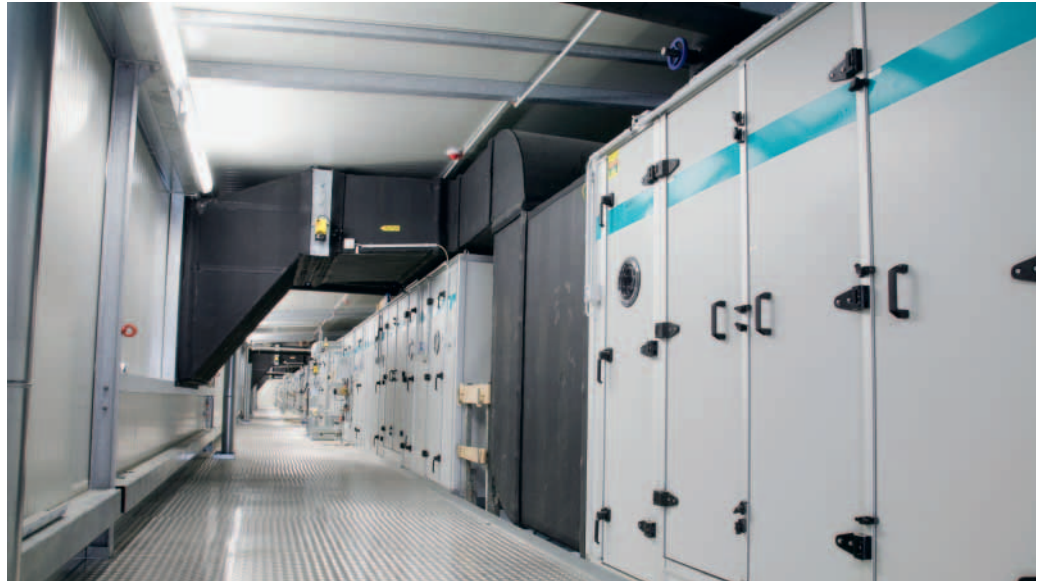
Der Technik-Gang auf der Galerie-Ebene
